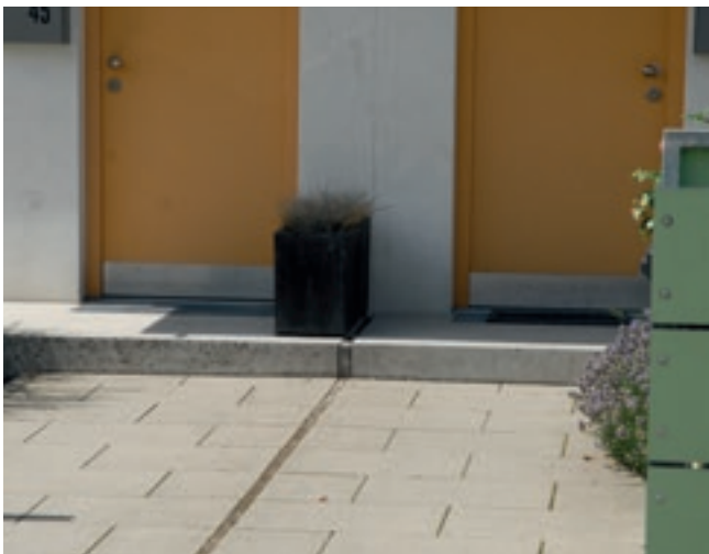
21 Aufkantung am Gebäudezugang
